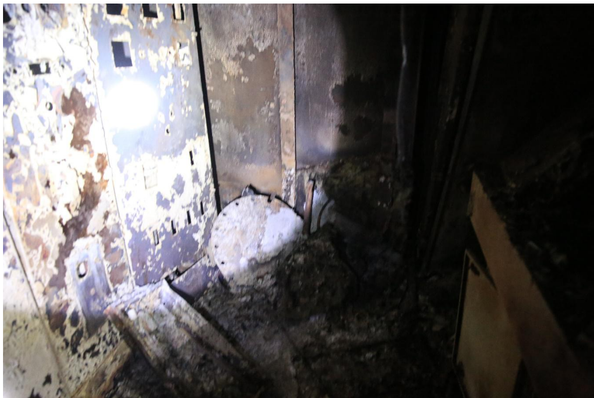
图 7：火烧过的集控室和变形破损的人孔盖
